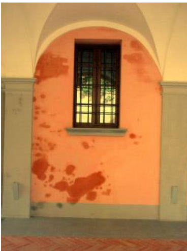
Fig. 2 - Sottoportico a Imola appena intonacato con buon intonaco a calce. Le zone bagnate sono il risultato di cuci-scuci nel restauro del muro fatto con mattoni di recupero dalle ex-stalle pieni di sali nitrati igroscopici. Questi sono stati estratti dall'acqua del nuovo intonaco e sono ora in superficie dove la loro igroscopia causa macchie di bagnato.
