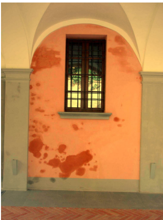
Fig. 2 - Sottoportico a Imola appena intonacato con buon intonaco a calce. Le zone bagnate sono il risultato di cuci-scuci nel restauro del muro fatto con mattoni di recupero dalle ex-stalle pieni di sali nitrati igroscopici.
